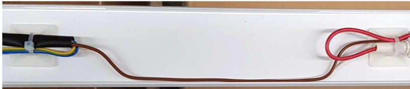
Exakte Kabelverlegung Geräteträger / Exact cable routing equipment carrier
